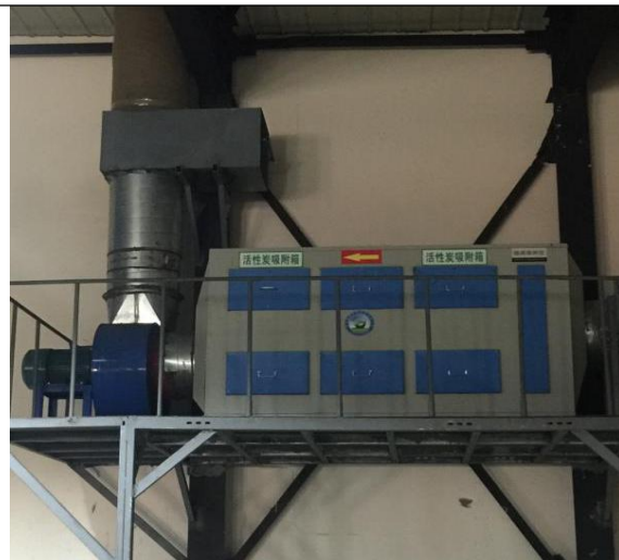
活性炭净化设施
