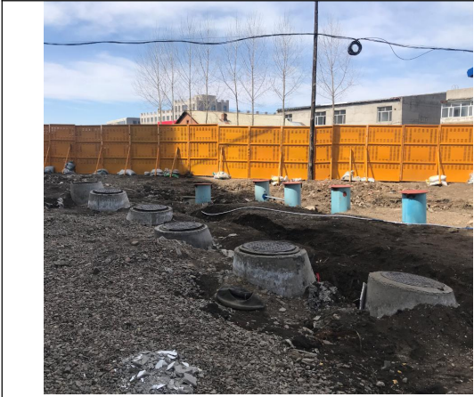
污水处理站地上检查井（地下为反应池）
