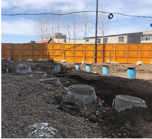
污水处理站地上检查井(地下为反应池)
