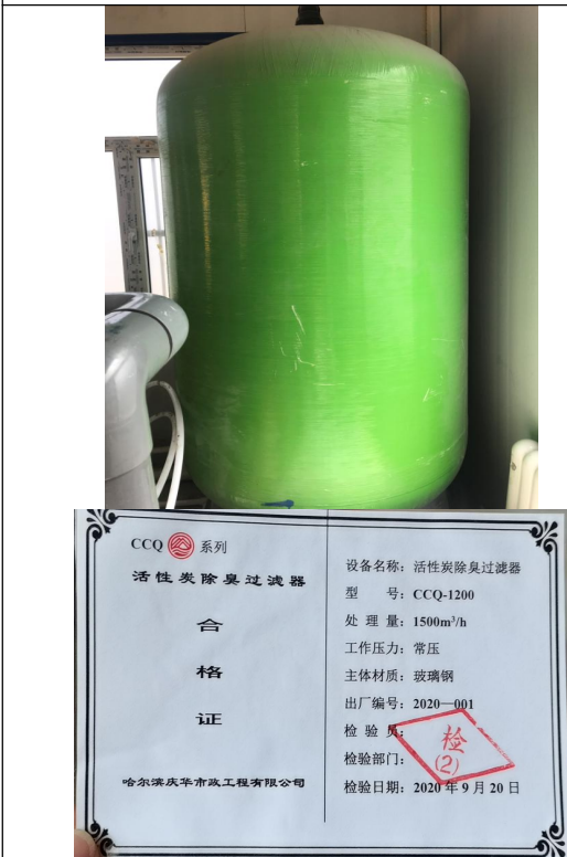
污水处理站活性炭罐及合格证
